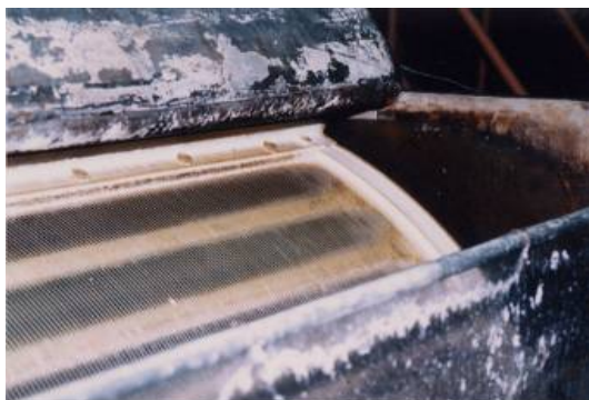
抄紙機(未設置ライン)
